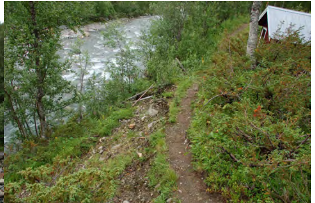
Bild 3.4. Erosion vid övre delen, längs trollstigen
