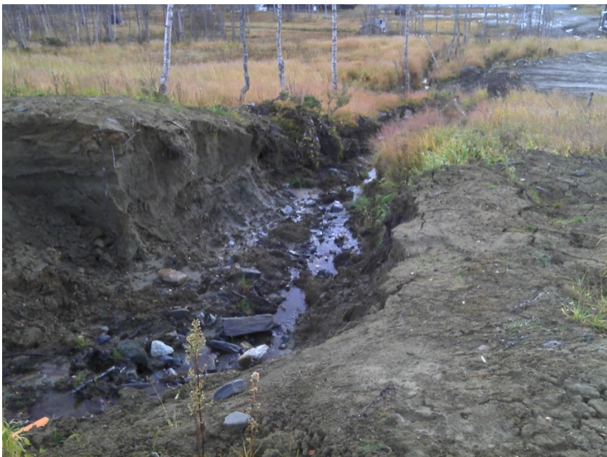
Figur 14 Erosionsskador i södra delen av planområdet.
